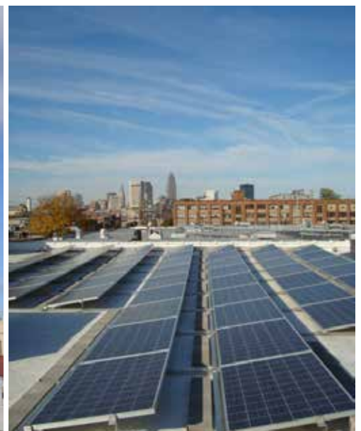
Midtown Solar Array
